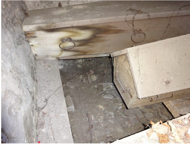
Afbeelding 20: Waterschade aan de meest zuidwestelijke doodskist in de hoofdruimte.
